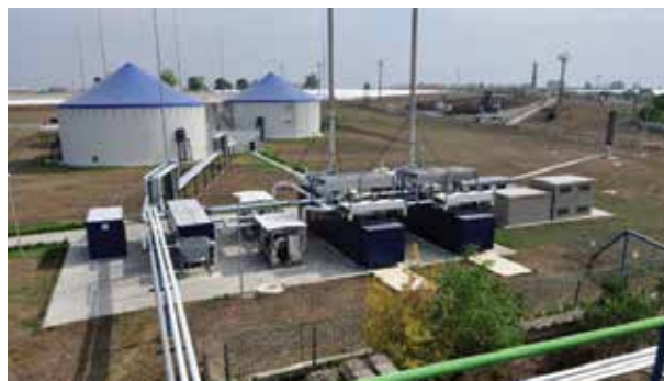
Fig. 33. Stația de biogaz și infrastructura de cogenerare și producere a energiei termice
