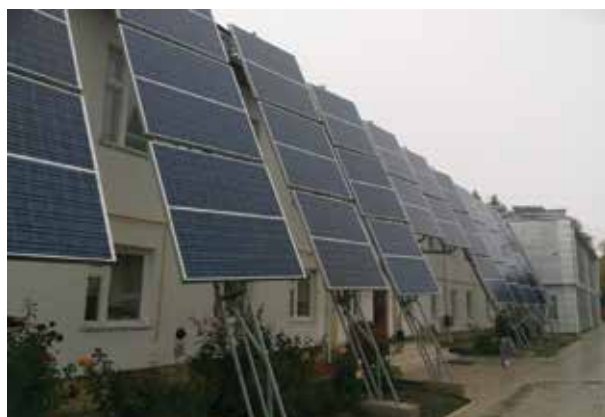
Fig. 37. Sistem de panouri fotovoltaice
