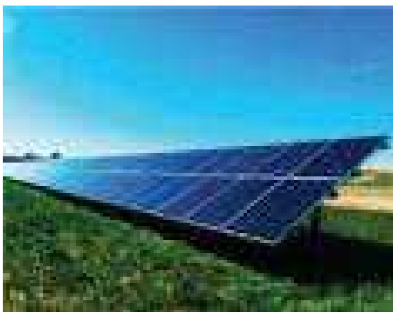
Fig. 6.3. Panouri fotovoltaice instalate la so
