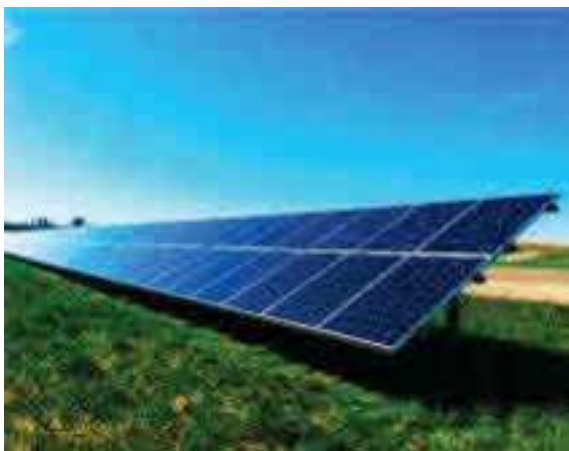
Fig. 7.3. Panouri fotovoltaice instalate la so
